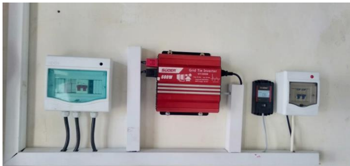
Gambar 4.4 Instalasi proteksi listrik dan inverter (Sumber:peneliti,(2020))
