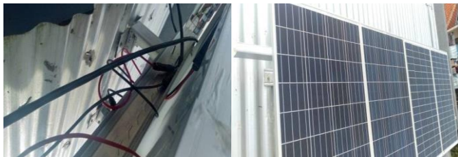
Gambar 4.2 Instalasi panel surya di atap rumah
