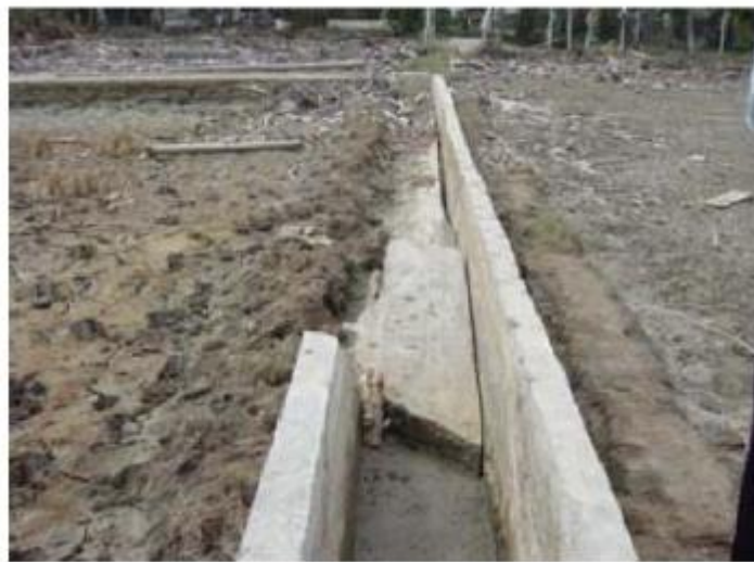
Gambar 2.1. Saluran Irigasi Yang Rusak Akibat Bencana Tsunami Provinsi NAD (Sumber: K Subagyono)
