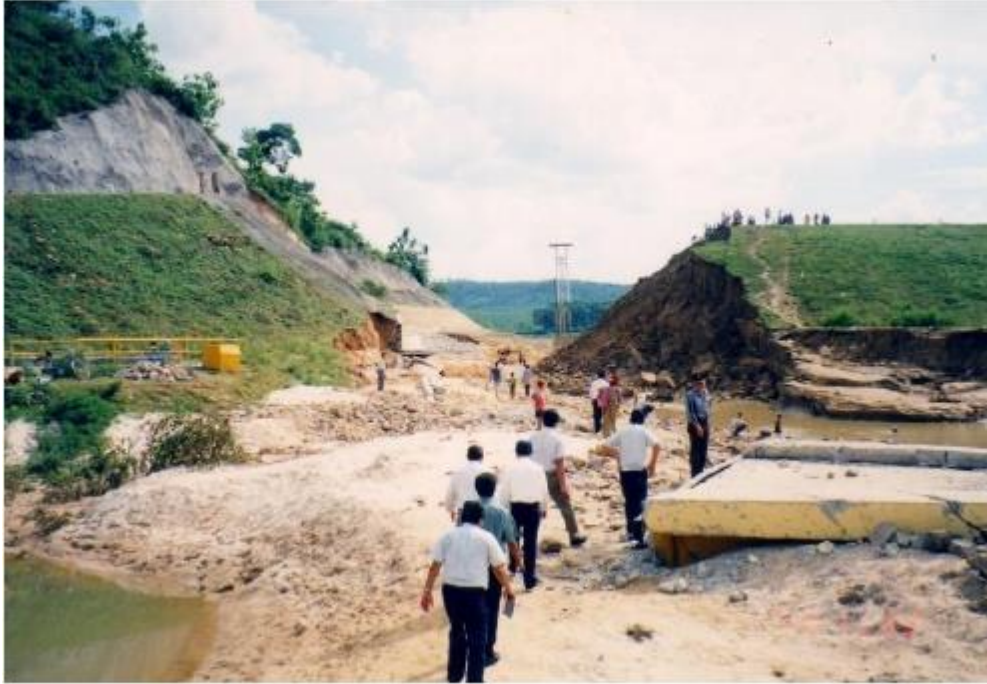
Gambar 2.3. Embung Lodan Kab. Rembang Yang Mengalami Bencana Keruntuhan (Foto: Inspeksi BKB)
