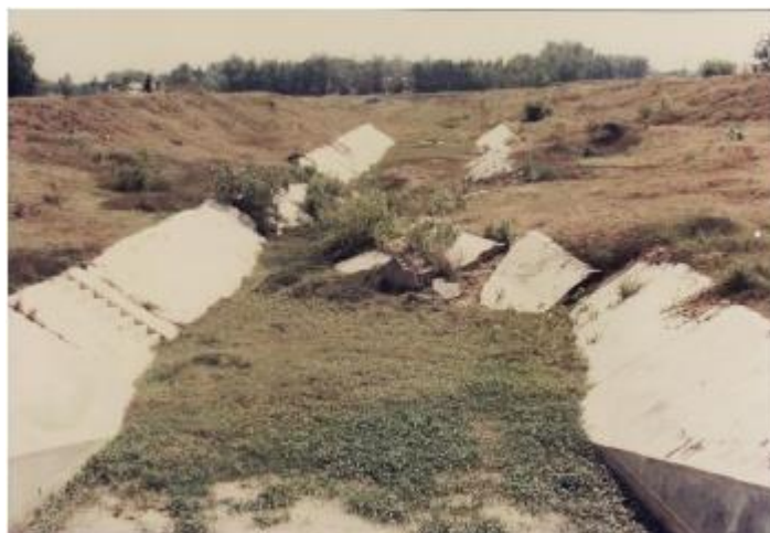
Gambar 2.2. Bencana Longsor Pada Saluran Irigasi Dumpil Kab. Grobogan (Sumber: Zainuddin)
