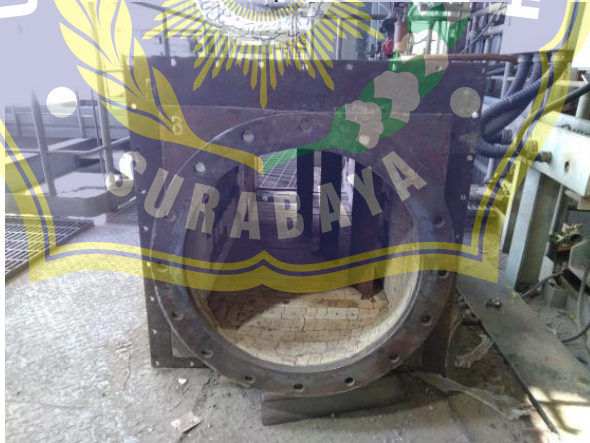
Gambar 2.3. Burner Dalam Kondisi Perbaikan (Sumber : PLTU 3 Jawa Timur Tanjung Awar-Awar)
