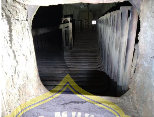
Gambar 2.4. Kondisi Ruang LTS Dilihat Dari Main Hole (Sumber : PLTU 3 Jawa Timur Tanjung Awar-Awar)
