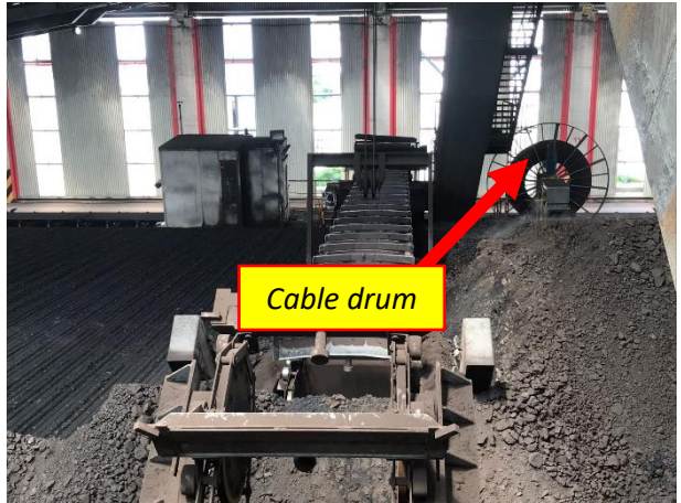
Gambar 2. 10 Cable drum (Sumber: Dokumen Peneliti)
