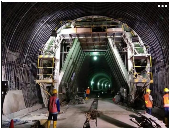
Gambar 4.19: Foto pelaksanaan pemasangan bekisting dengan slidding form sistem hidrolis Sumber : Data Teknik PT Brantas Abipraya (Persero) 2020
