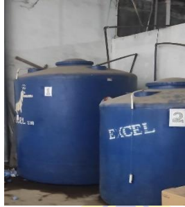
Gambar 4. 2 Tandon 1 dan 2 (Sumber: PT. UMSurya Bina Bangsa)
