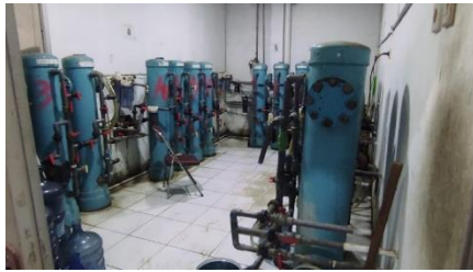
Gambar 8 Ruang Filtrasi Air
