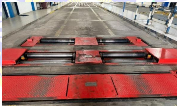
Gambar 3.7 Alat Uji Axel Load Meter
