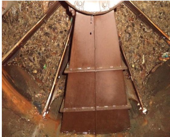
Gambar 2.8 Ditemukan tumpukan sampah pada strainer
