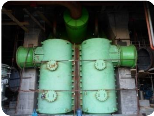
Gambar 2.2 Kondensor pada PLTU
