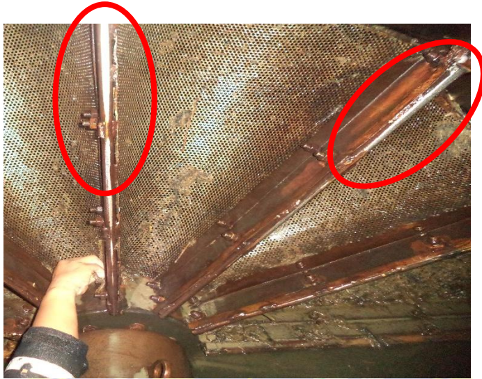
Gambar 2.7 Ditemukan adanya bekas gesekan bucket pada ujung strainer
