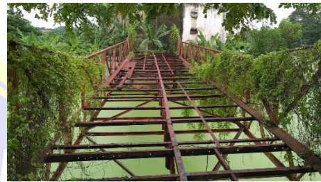
Gambar 1. 4 Jembatan besi tua berkarat
